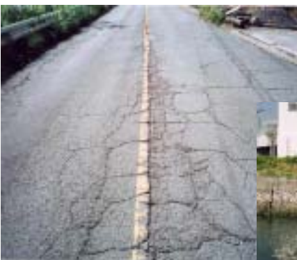
道路 (ひび割れた舗装)
