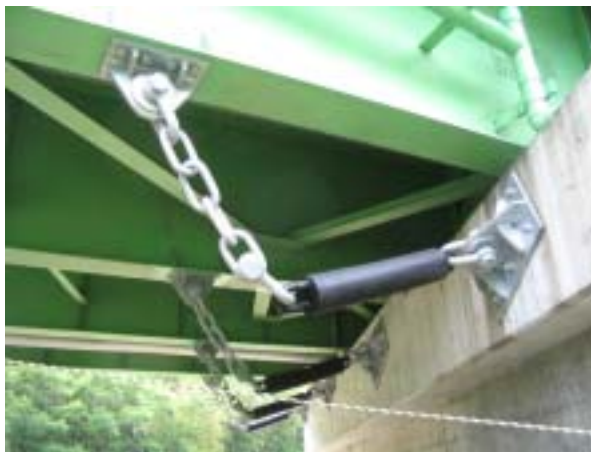
橋梁の桁と橋台を連結し、震災時に落橋を防止します。
