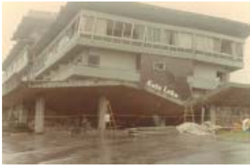
地震による建物の被害
