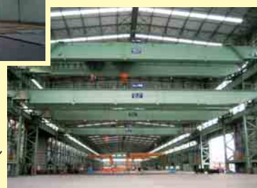
120 t/60 t×44.8m天井クレーン 30 t×44.8m天井クレーン 20 t×44.8m天井クレーン
