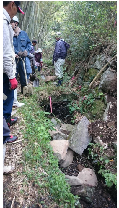
農業水路への落石 (別府市山の口地区)
