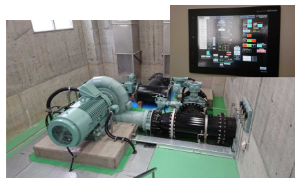
発電機及び操作モニター
