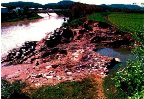
写真 2. 1. 5 安岐川右岸の氾濫流による 荒木川の被災状況 【平成 9 年 9 月洪水】
