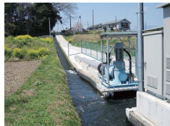
農業用水を利用した小水力発電
