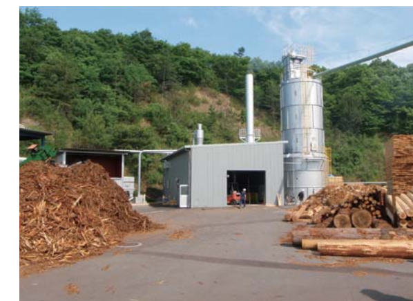
製材工場に導入された木質バイオマスボイラー
