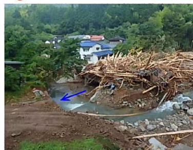
③ 橋梁(中崎橋)流木阻害状況
