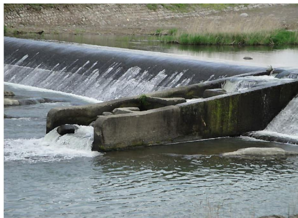
写真2 アユが遡上口を見つけにくい魚道
