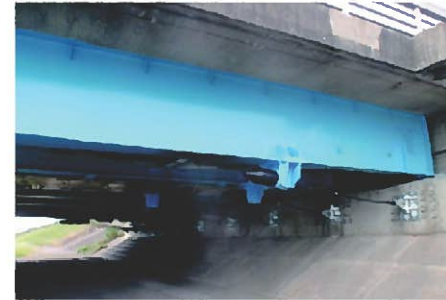
落橋を防ぐ耐震対策 (大分県大分港線弁天大橋：大分市)
