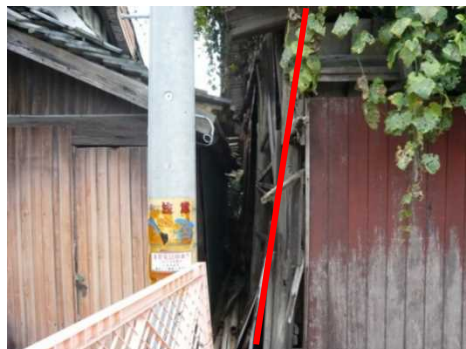
柱が傾斜している
