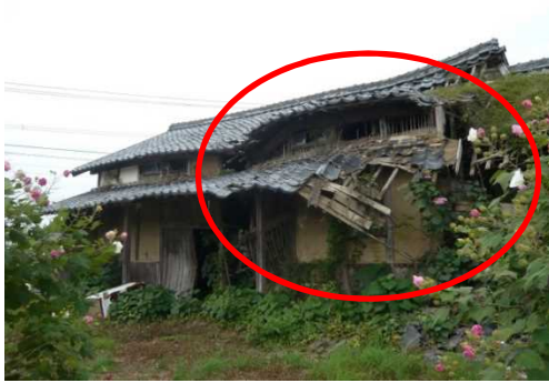
屋根が一部落下している
