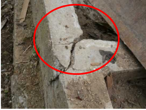
基礎がひび割れ、土台が無い
