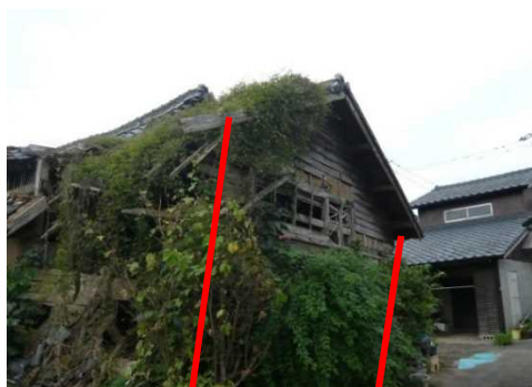
建物が傾斜し、道路に倒壊の危険
