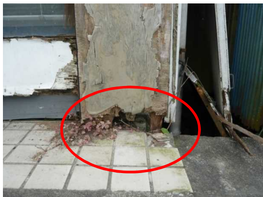
柱脚が腐朽し欠損している
