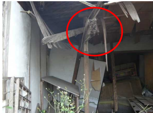
柱、梁が破損している
