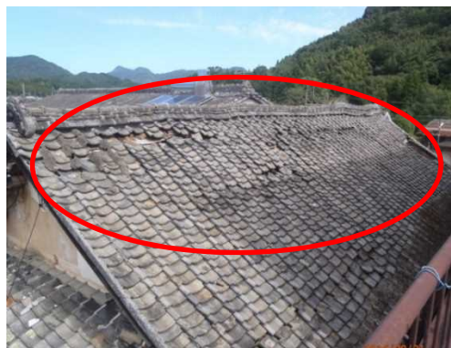
瓦が周囲に飛散する危険がある
