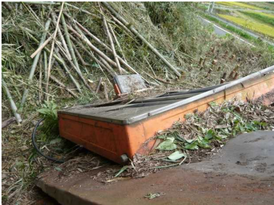
屋上給湯設備の落下
