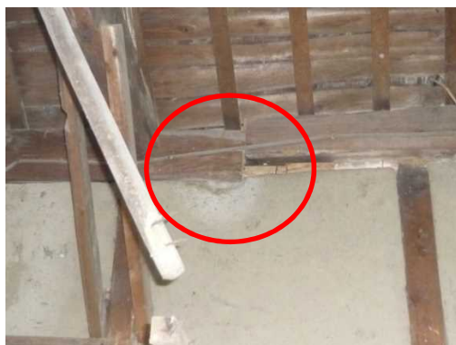
梁の接合部がずれている
