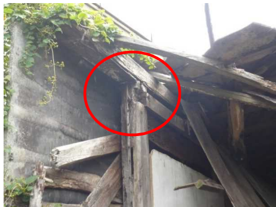
梁の腐食により欠損している
