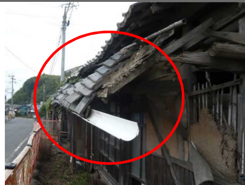
屋根、軒が垂れ下がっている
