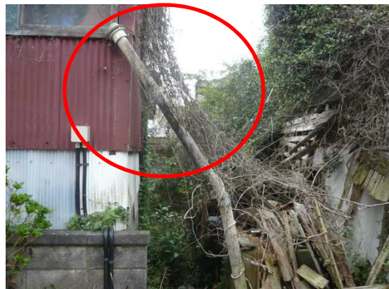
臭気筒が隣地へ倒れている
