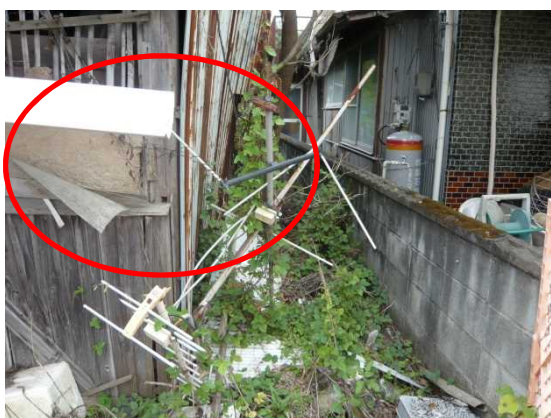
外壁材が剥がれている
