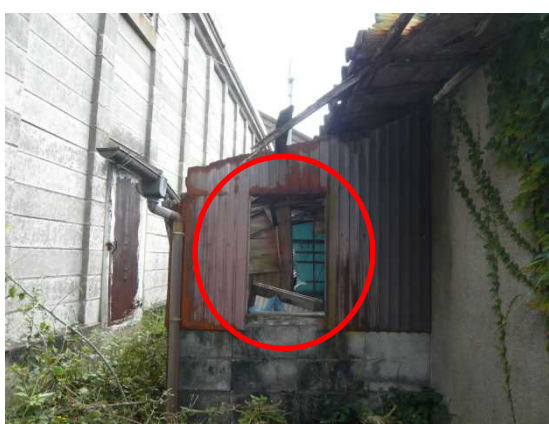
門扉がなく侵入できる
