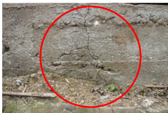
基礎にひび割れが発生している
