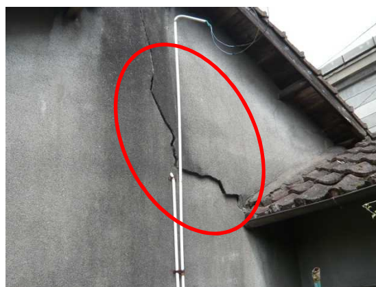
外装材にひび割れがある
