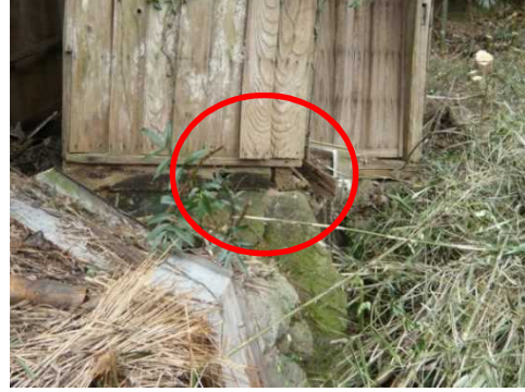
土台が腐朽して欠損している
