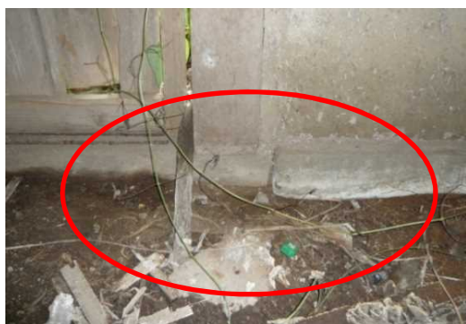
基礎、土台がずれている
