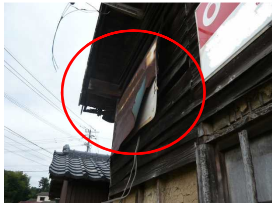
鉄製看板の落下の危険性
