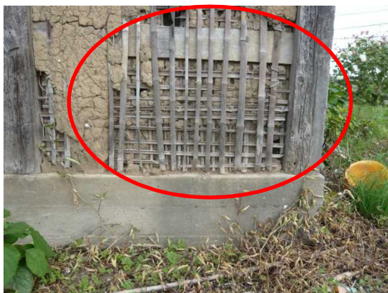
外壁材が剥がれて土壁が露出
