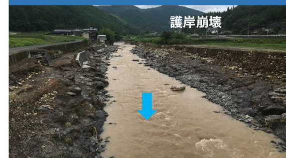
右岸崩壊による被害状況
