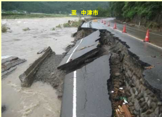
●山国川増水による兼用護岸の流出 (中津市耶馬溪町戸原)
