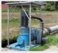
竹田市 城原井路小水力発電所
