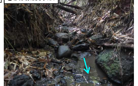
③溪流荒廃状況
