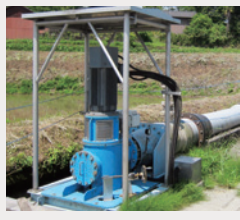
竹田市 城原井路小水力発電所
