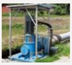
竹田市 城原井路小水力発電所
