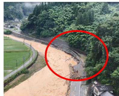
孤立地域内の道路崩壊を確認
