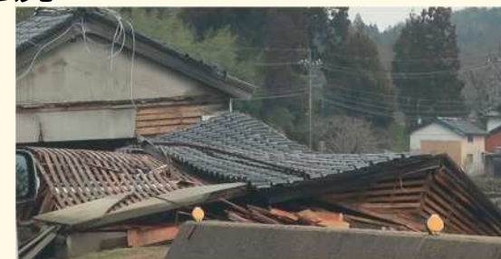
被災した木造家屋（能登半島地震）
