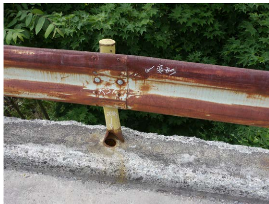
防護柵支柱の破断
