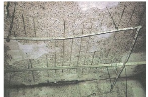
火害によるコンクリートの爆裂
