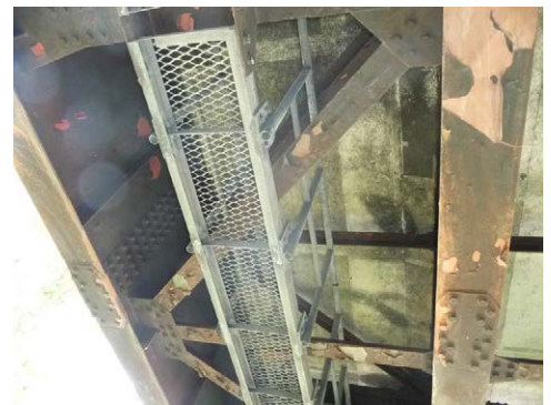
火害による塗装のはがれ
