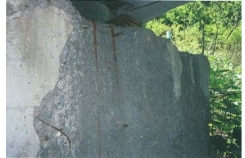
凍害によるコンクリートの劣化
