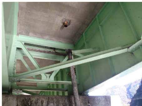
排水管の破断
