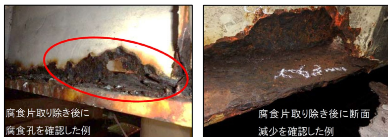
腐食片を取り除いた状態の例(主桁)
