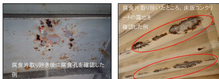
腐食片を取り除いた状態の例 (床版)
