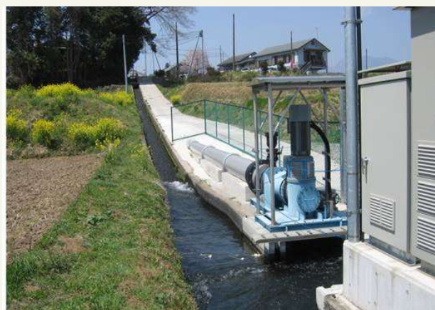
城原井路小水力発電所(竹田市)
