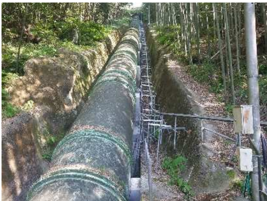
（芹川第二発電所 水圧管路）
