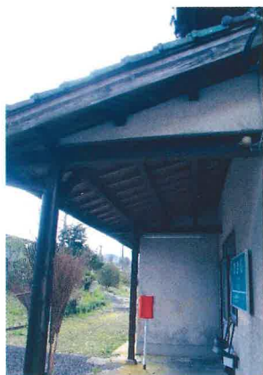
ホーム側入口側面軒の張り出しなど木造駅舎の特徴を良く残している。
