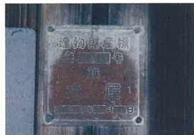
建物財産標 腐食が激しく判読困難
