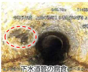
下水道管の腐食 上田の湯町(別府市)
