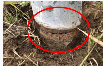
撤去:腐食が進行し亀裂確認
