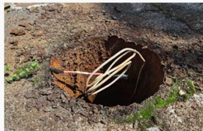
倒壊後照明柱基部状況
