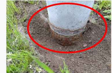
詳細調査:地中部において発錆確認
