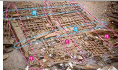
▲平櫓の柱や梁は全て折れていました(平成15年撮影)
