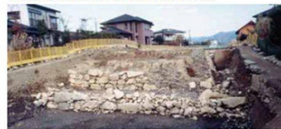
▲麦島城の小天守の石垣。地震で石垣の隅や上部が失われています(平成15年撮影)
