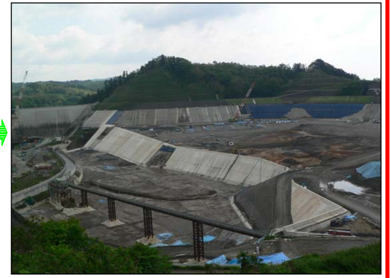
貯水池対策工事 撮影日:平成19年7月19日(コンクリートフェーシング施工状況)
