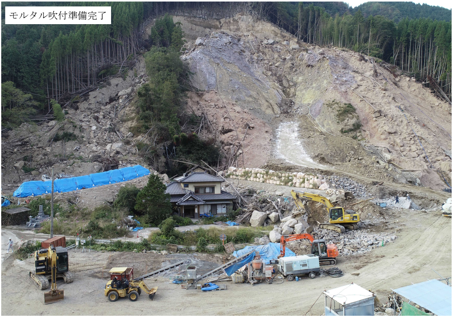
巨岩破碎状況
