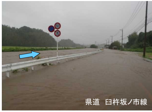
熊崎川浸水写真(H23年9月)
