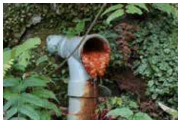
水抜き孔が詰まり、機能が低下
