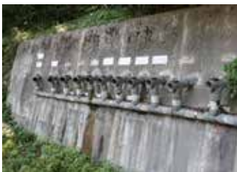
地下水位を下げて地すべりを抑制する水抜きボーリング
