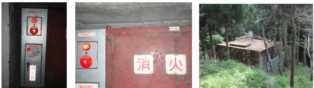
図15 消火器、消火栓、貯水槽
