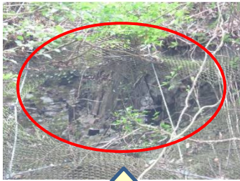
ネットの破損
