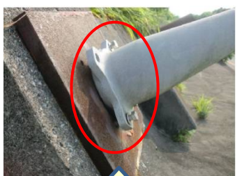
頭部キャップボルト 緩み・欠損
