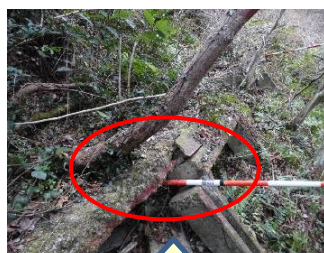
天端部の破損
