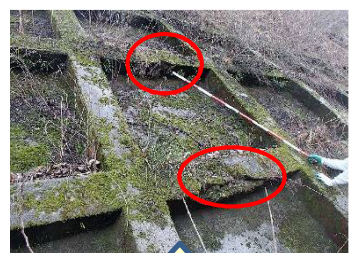
破損・鉄筋の露出
