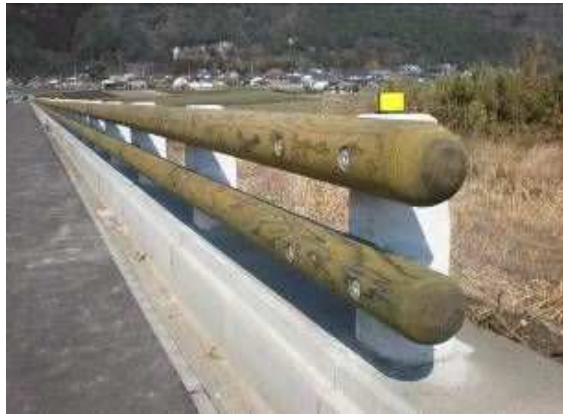
木製ガードレール
