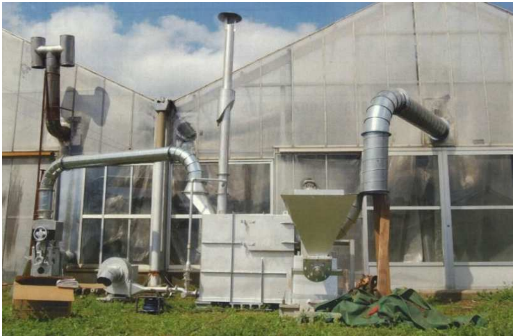
（設置状況写真）設置場所：大分県日田市天瀬町 （有）マルカ農園
