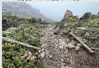
腐食により抜けた杭
