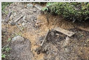
洗堀等で崩れた階段
