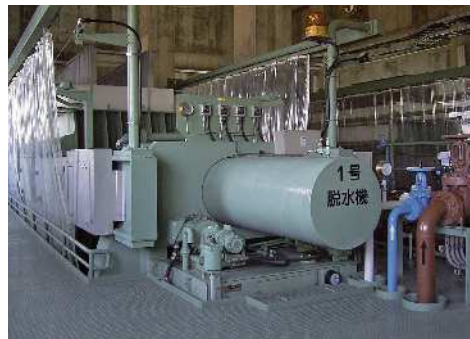
加圧脱水機(汚泥処理設備)
