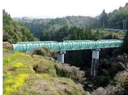
三重川水管橋
