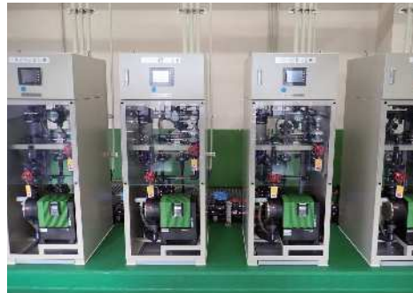
薬品注入ポンプ
