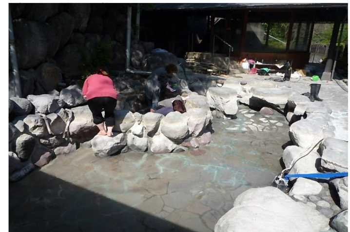
浴槽のひび割れ（同左）
