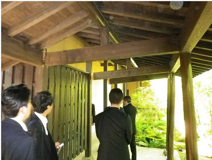
支柱のずれ・ゆがみ（由布市湯布院町）
