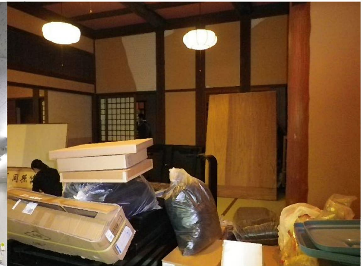
壁の崩落、駆体ゆがみ（同左）
