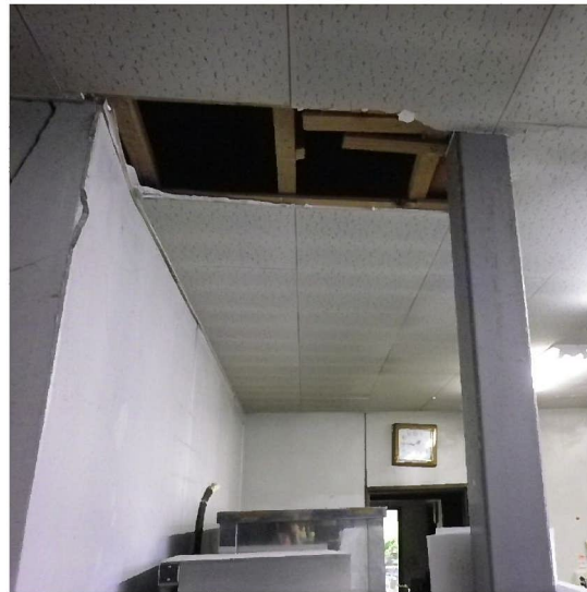
厨房天井の落下（同左）
