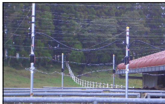
写真3 センサー設置状況
