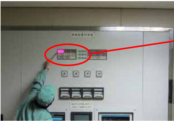
焼却炉設備制御盤（代表警報）
