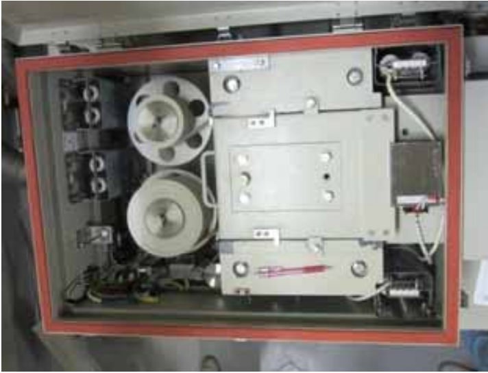
焼却炉排気筒じんあいモニタ (検出部)
