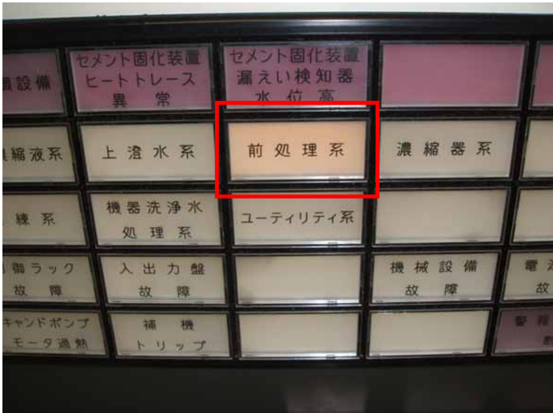
セメント固化装置制御盤（現地）
