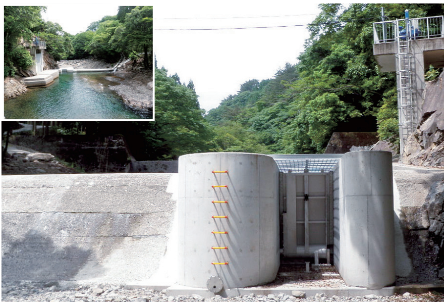
「土砂吐のゲート化で管理効率の向上（長谷緒頭首工）」 中山間地域総合整備事業（豊後大野西部地区）
