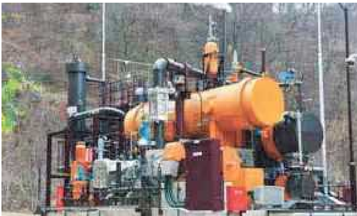
図3-10 土湯温泉16号源泉バイナリー発電所
