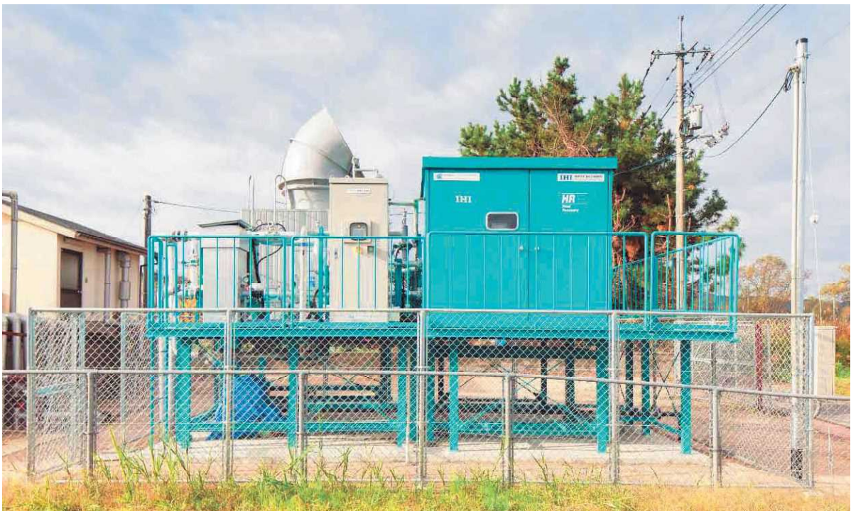
図3-9 湯梨浜地熱発電所
