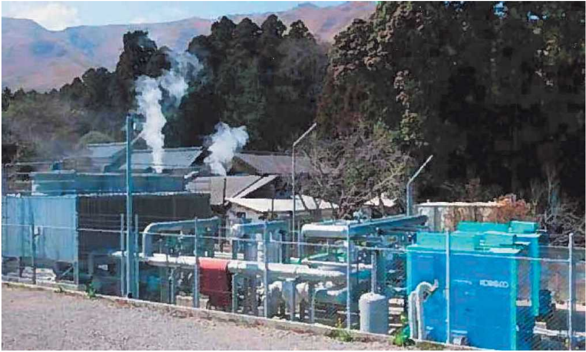
図3-8 湯山地熱発電所
