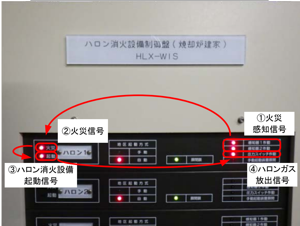
焼却炉建家 ハロン消火設備 制御盤
