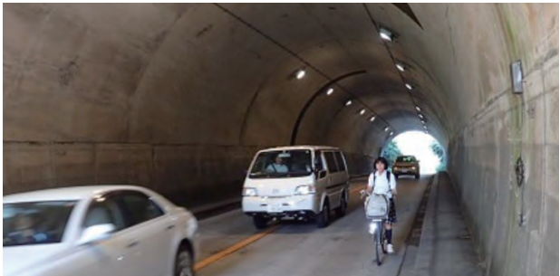
路肩が狭く、車両が自転車を避けて走行している状況
