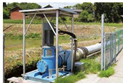
農業用水を活用した小水力発電(城原井路発電所)
