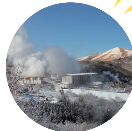
地下岩盤の蒸気を利用した「八丁原地熱発電所」。次世代エネルギーとして注目されています。
