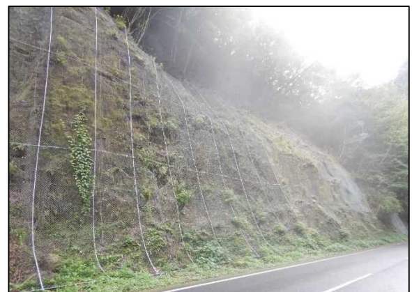
落石防護柵・落石防護網（落合斉藤線）
