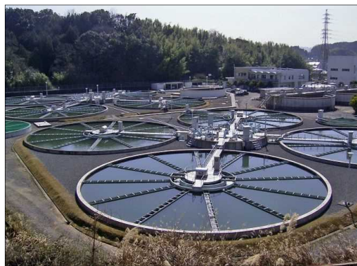
浄水場（判田浄水場）
