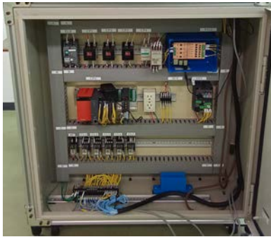
図4 制御盤内の配線部分
